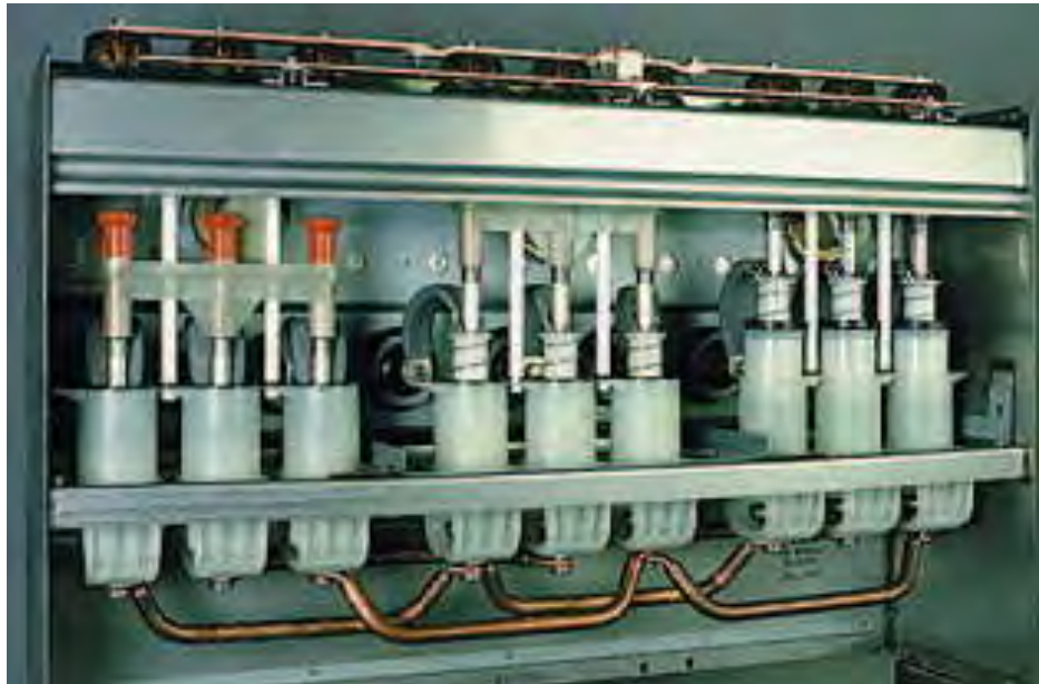
شکل (۱۵): نمونه‌ای از شینه‌بندی داخل تابلوی کمپکت GIS
