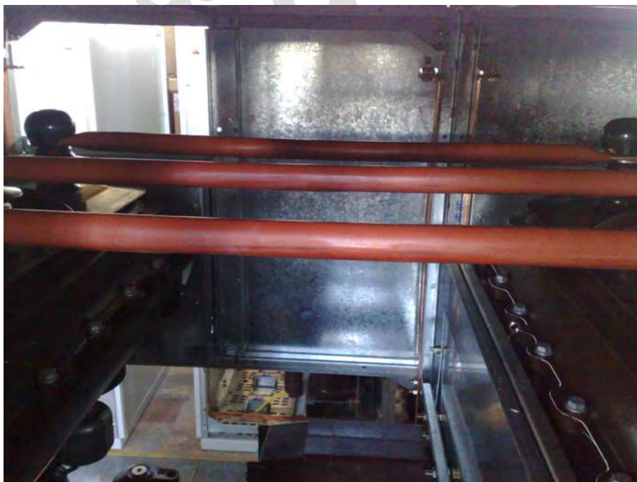
شکل (۱۴): نمونه‌ای از شینه‌های تابلوی فشار متوسط کمپکت AIS
