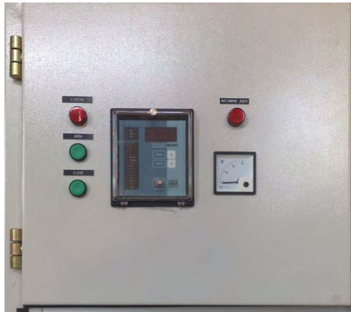
شکل (۲۷): نمای روبروی محفظه کنترل و حفاظت
