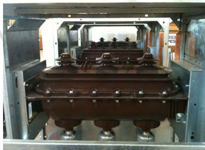
شکل (۱۶): نصب سکسیونر قابل قطع زیر بار گازی در داخل تابلو
